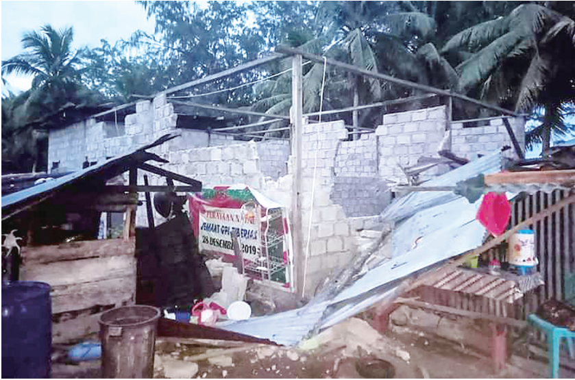
这是1月10日在印度尼西亚马鲁古省拍摄的在地震中受损的房屋。印度尼西亚马鲁古省附近海域10日凌晨发生7.5级地震。
