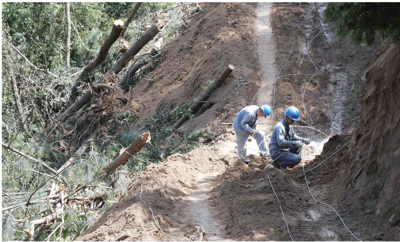
8月1日上午,潜山市槎水镇万全村一处塌方点,保供电工作正有序进行。 全媒体记者 储永志 摄
