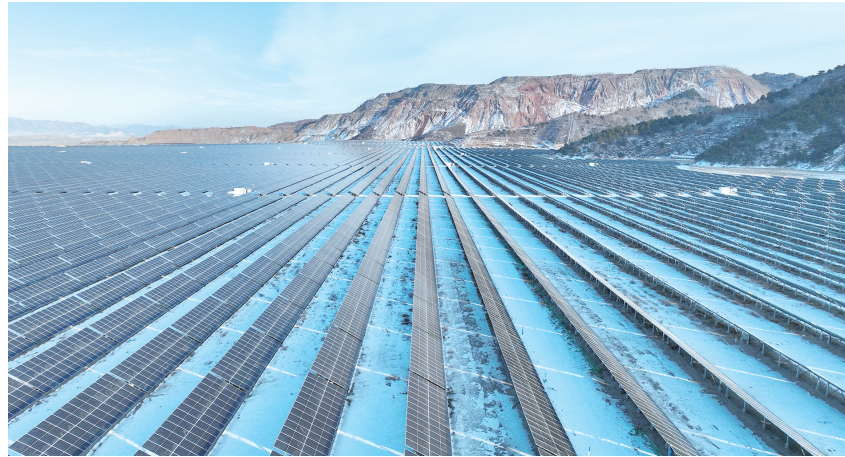
這是首鋼100兆瓦光伏發電礦山治理清潔能源示範項目發電場（12月26日攝）。目前，位於河北省遷西縣尹莊鄉的首鋼100兆瓦光伏發電礦山治理清潔能源示範項目完成主體工程建設，該項目利用近3000畝尾礦庫閑置土地，採用“光伏+生態修復”模式，集礦業生產清潔能源應用、尾礦庫生態治理、地面分布式光伏發電、柔性光伏支架應用等於一體，實現“板上發電、板下固沙”。
