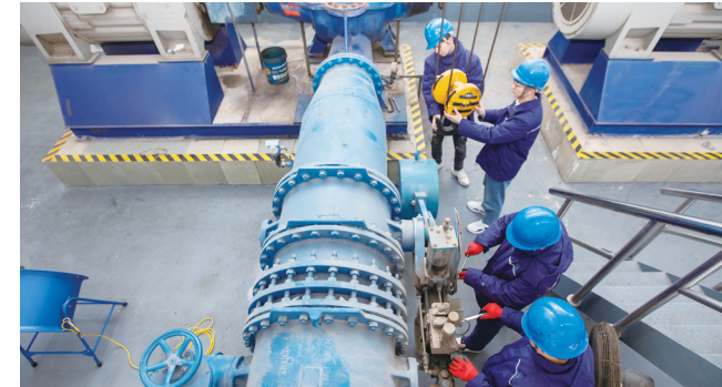
农历大年三十，供水人员正在检查维护送水机组设备。
