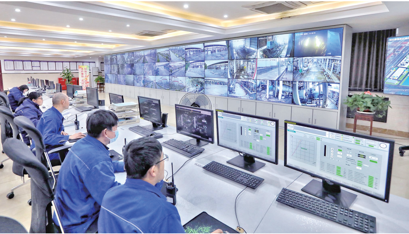
2月21日, 安庆高新区安庆泰恒石化(集团)有限公司职工在中控室实时观察设备生产情况。 全媒体记者 王政 通讯员 陈嵩 摄
