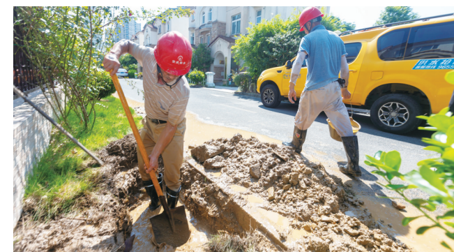
碧桂园山水云间273栋P110PE管破裂漏水维修。
