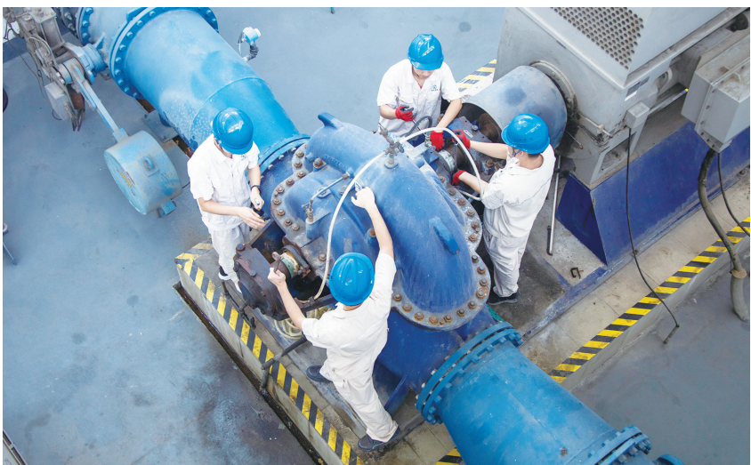
维修人员正在巡检送水泵房机组设备。
