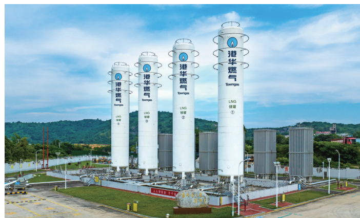
2017年11月，我市首座液化天然气应急气源调峰站投入试运行，有效提升城市燃气应急保障能力。
