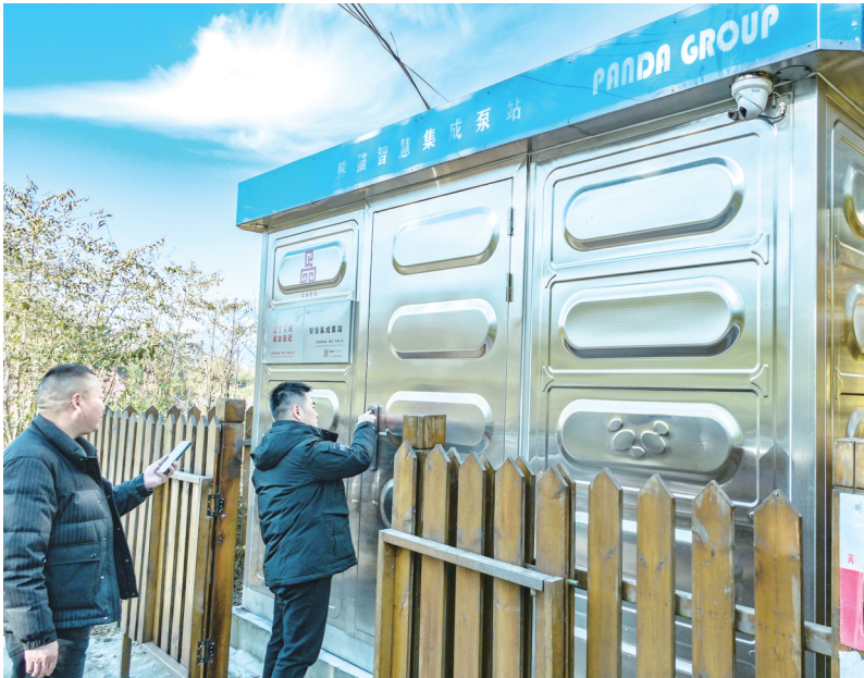
岳西县天堂镇木冲社区工作人员正在查看智慧集成水泵站运行情况。通讯员 王先国 摄
