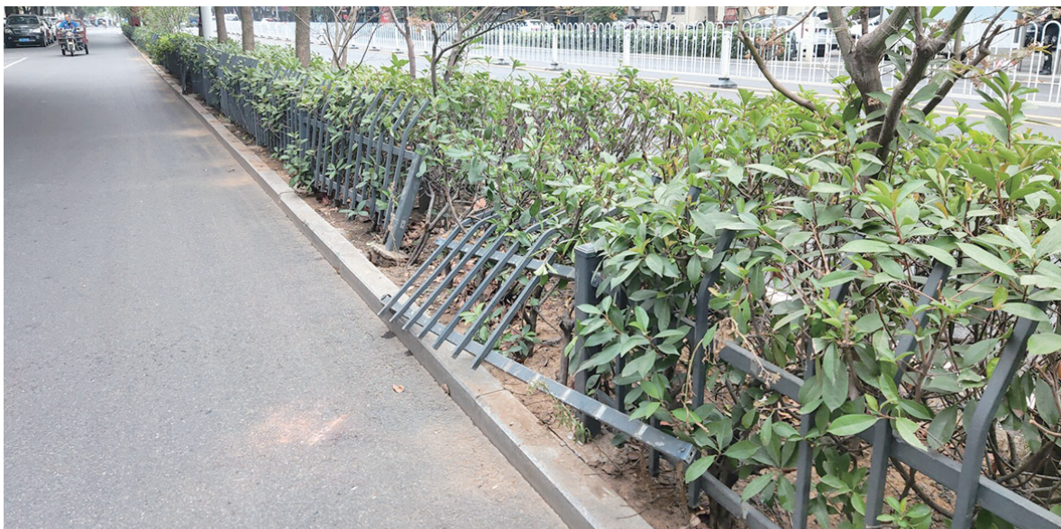
图为损坏的绿化带护栏
