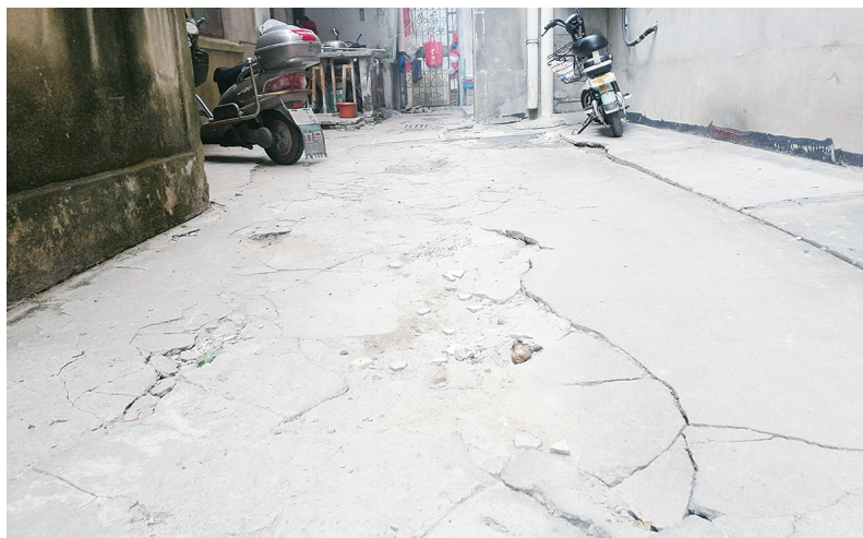
图为宿舍区地面破损严重
