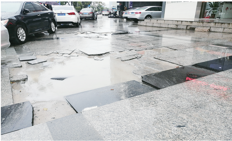
图为人行道上破损地砖
