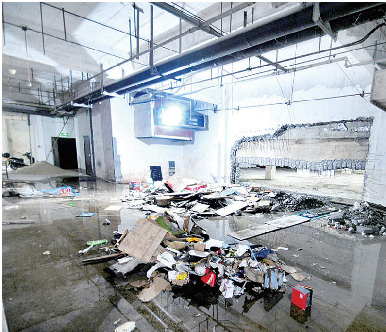
图为被拆除的人防墙至今未恢复
