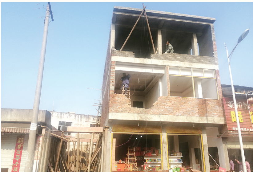
怀宁县秀山乡栏坝街上违法建房。
