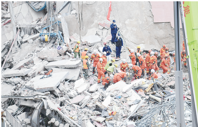
3月8日拍摄的福建泉州欣佳酒店坍塌事故救援现场。据应急管理部官方微博消息,福建省泉州市欣佳酒店“3·7”房屋坍塌事故现场共有71人被困(不含自救逃生的9人)。截至3月8日16时,已救出48人(其中10人死亡,38人送医治疗),正在搜救的还有23人。 新华社发
