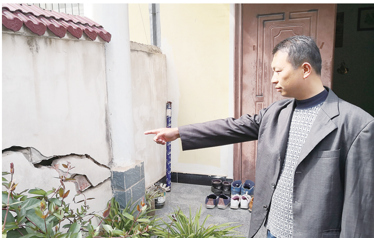
图为居民家院墙被震出的裂缝
