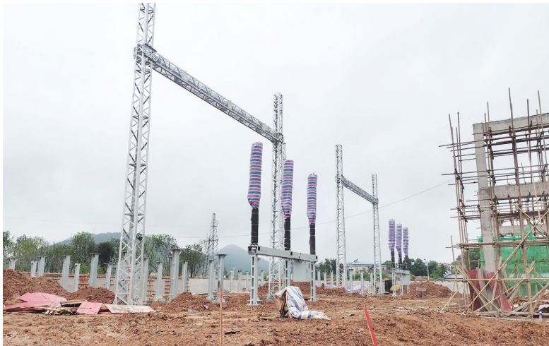
新安庆西牵引变电所进线架构完工 (6月10日摄)。
