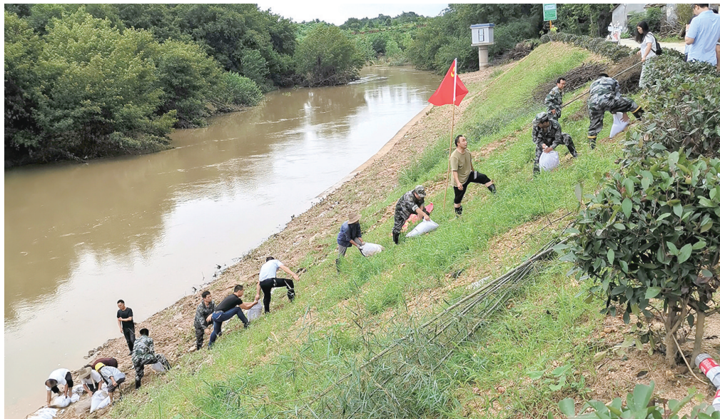
7月7日,怀宁县马庙镇人行河泥河段发生管涌险情,县水利局工程技术人员和镇村抢险队伍紧急上堤抢险,一个小时后顺利控制住险情。 檀志扬 梁红 摄
