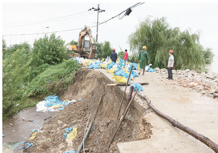
龙塌圩塌方路段。 记者 程扬 通讯员 王彰平 摄
