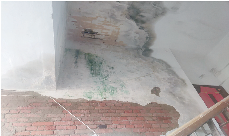
图为漏雨的房顶一角。
