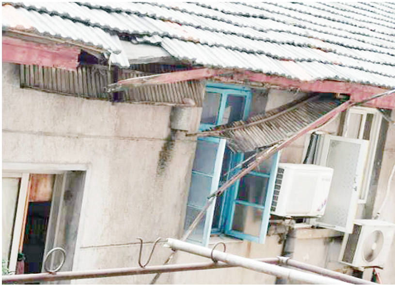
图为居民居住的楼房屋顶已损坏,破烂不堪。
