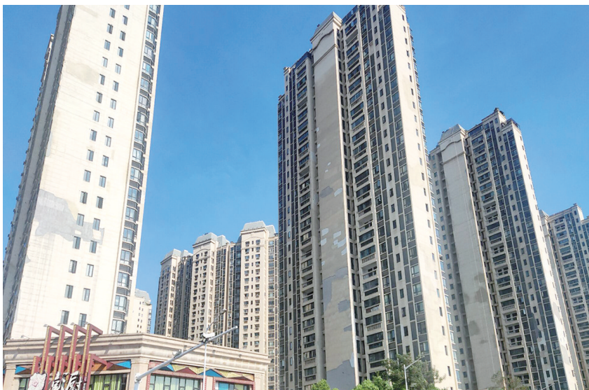
凯旋尊邸小区部分楼房外墙脱落
