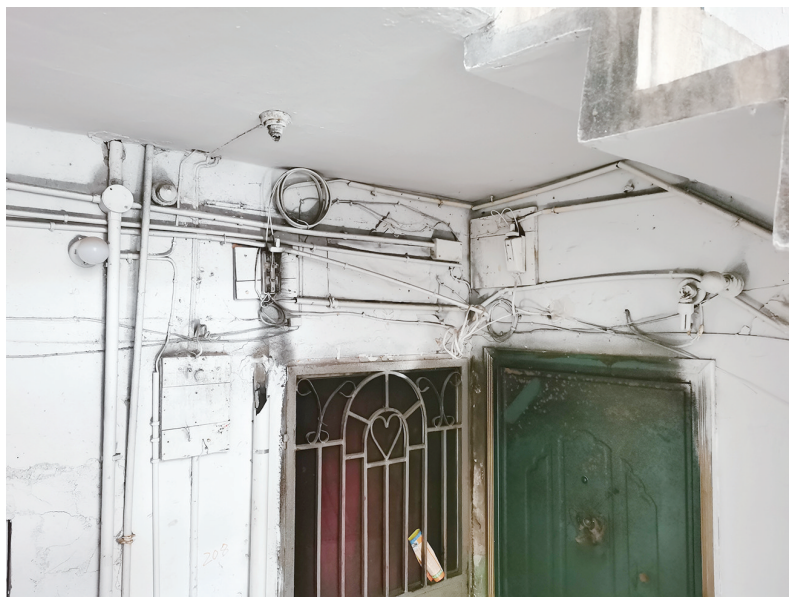
后围墙7栋4单元2楼有4个灯座,电线缠绕混杂。
