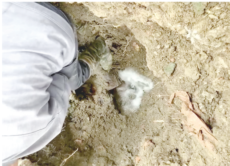
3月20日,宜秀区叶祠南苑发现的漏点。 安庆供水集团提供
