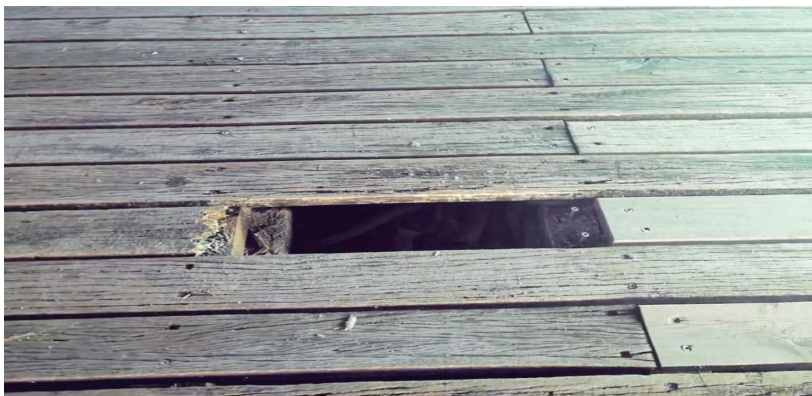
图为木栈道木板缺失。
