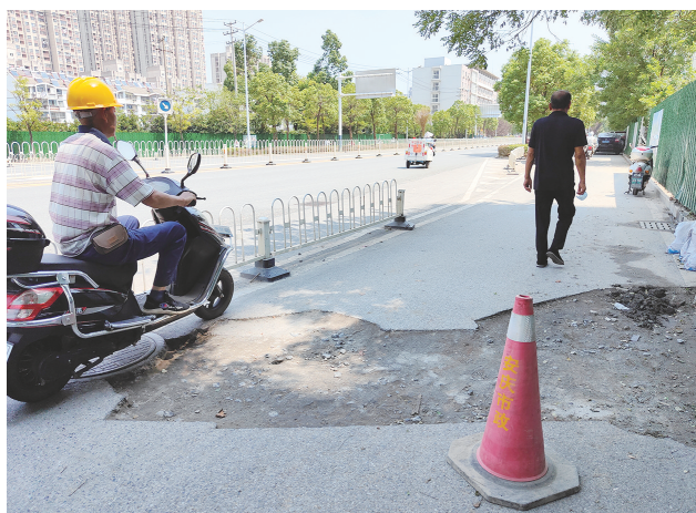
未填补的坑槽影响市民通行
