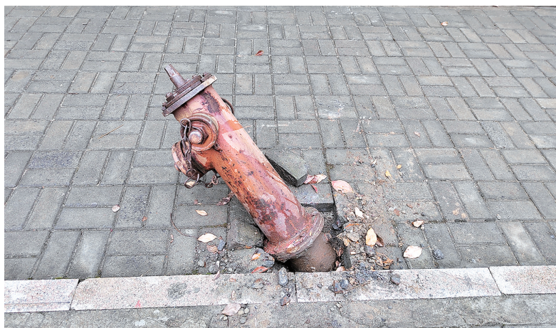
春华路中段的消防栓被撞倒。
