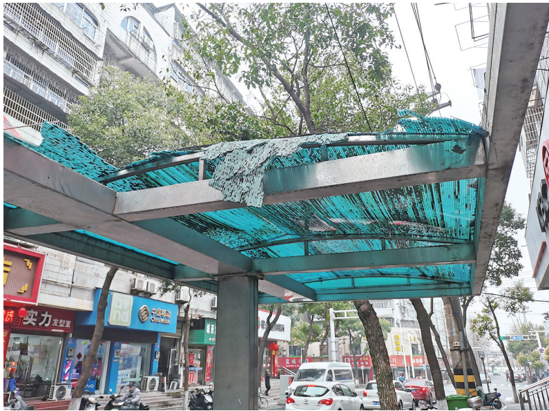
玉琳路北侧公交站亭顶棚的玻璃瓦严重破损。
