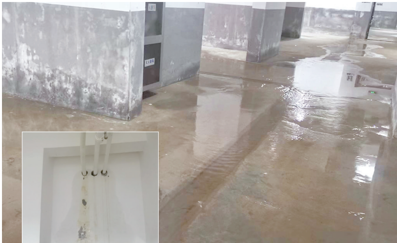
▲ B6地下车库地面被淹。 ◀ B6地下车库墙面渗水。
