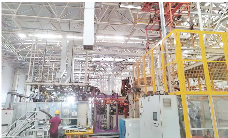
冷凝水通过管道输送到冲焊车间屋顶的水冷风扇里,利用冷凝水给车间降温。
