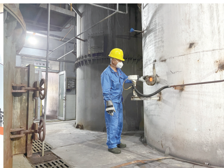
潘总结在焚烧车间巡检。
