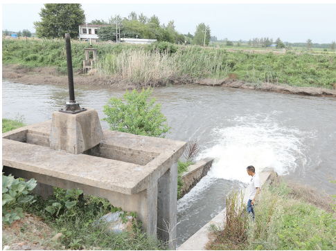
8月16日,望江县太慈镇六零圩排灌站,工作人员巡查出水运行情况。
