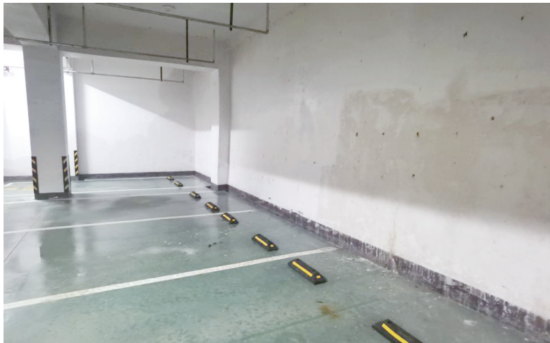
北城秀里小区地下车库潮湿,墙壁上的腻子被泡成了泥浆滑落到地面。
