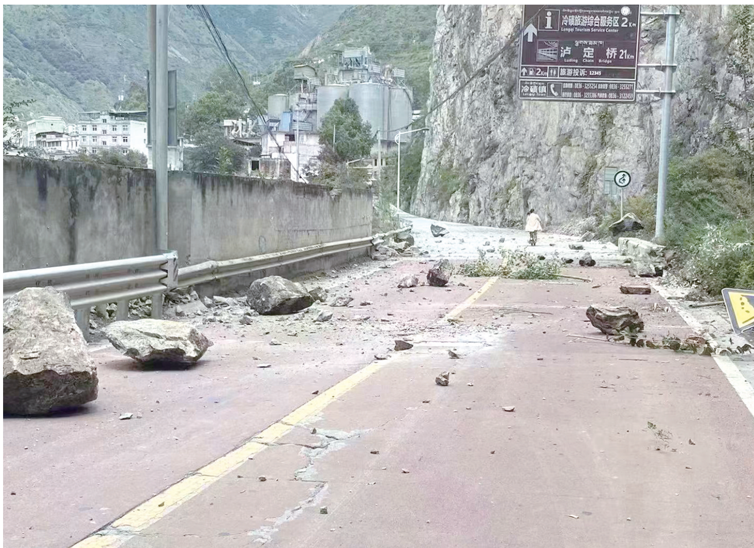
图为山石掉落在四川省甘孜州泸定县冷碛镇附近的道路上(9月5日摄)。据中国地震台网正式测定,9月5日12时52分四川甘孜州泸定县发生6.8级地震,震源深度16千米。
