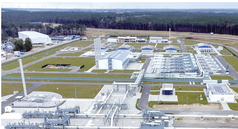
“北溪-2”天然气管道项目登陆设施的管道。 图源：中新网
