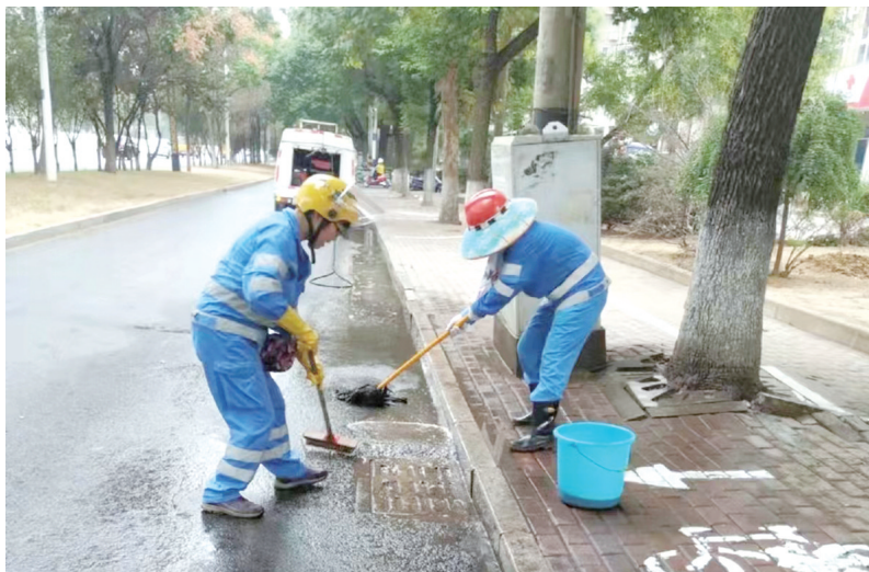
环卫工人正在清理五里路与集贤北路交叉口一处的雨水井盖。
