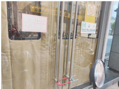
汇峰吾悦广场一安全出口被上锁。
