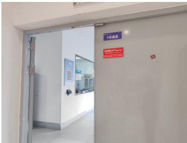
八佰伴商场一常闭防火门敞开。
