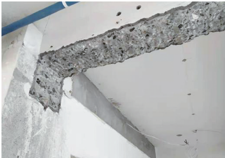
业主为房屋美观砸掉承重梁。图片由住建部门提供
