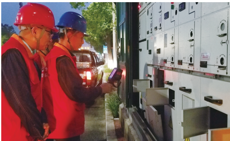
图为工作人员正在监测考点周边供电设备。通讯员 汪柏松 摄
