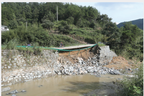
风景村通江畈组的道路被水冲毁,经抢修后能通过小型车辆。
