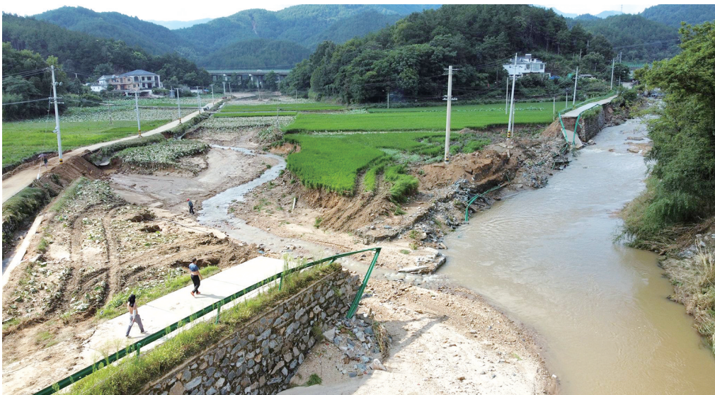
7月31日,村民在天柱山镇风景村九井河查看被洪水冲毁的道路。
