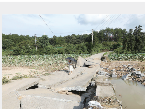
道路损毁严重,一名小女孩通过水毁路段。
