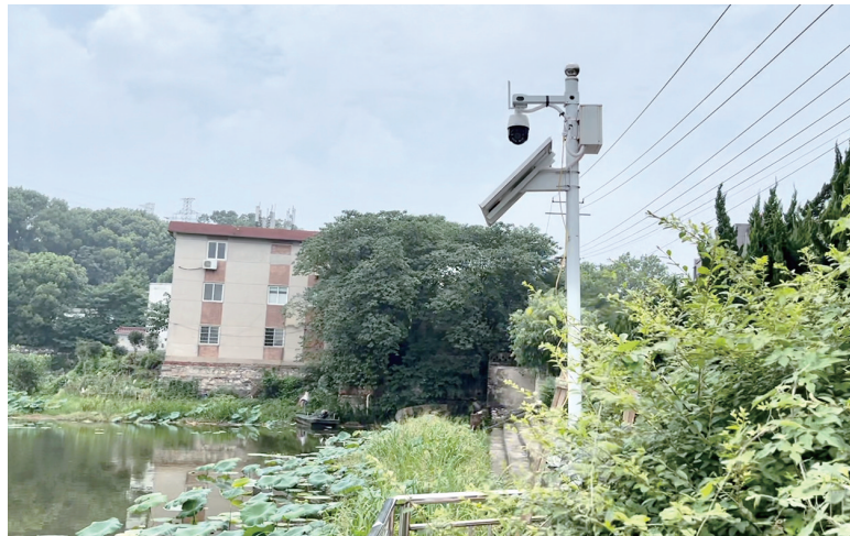
大观区十里铺乡袁江村杨山洼岸边的防溺水监控。
