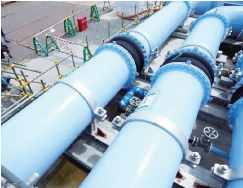
福岛第一核电站污水稀释排放设施中的海水输送管道。
