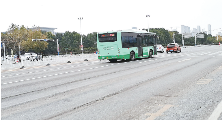
振风大道与顺安路交汇处路面的车辙印。
