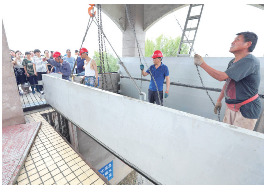
6月30日,安庆城市防洪墙闸门放下第二块闸板。 全媒体记者 江胜 摄
