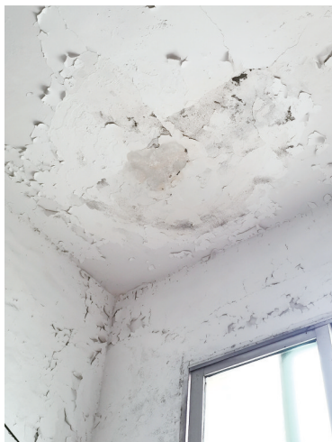
顶楼过道内有渗水痕迹。
