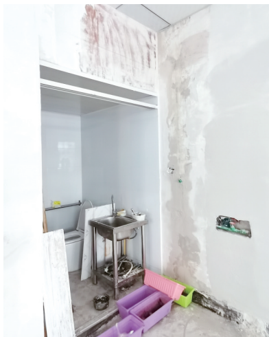
门面房内刚刷的墙漆进了水。
