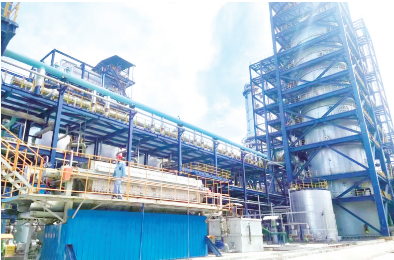
工作人员对板框压滤机进行日常检查。
