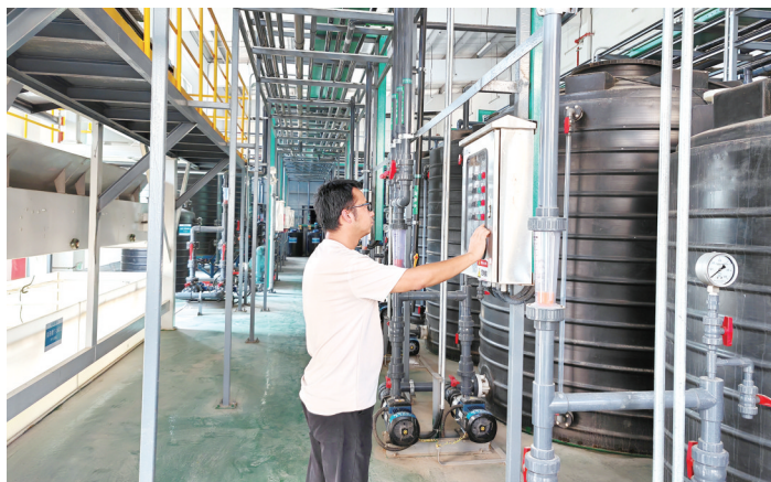
技术人员正在检查二期环保设备。
