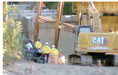
桥梁坍塌事故现场。新华社发
