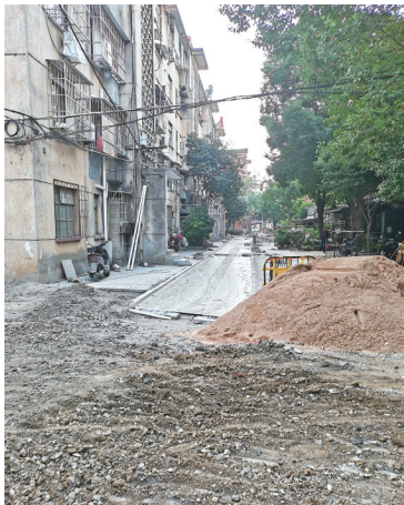
路面坑洼不平,砂石裸露。
