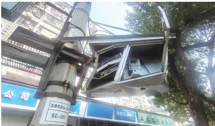
摇摇欲坠的电表箱让路过市民心存疑虑。
